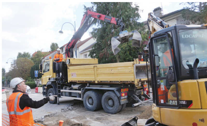
La réfection de la rue de la Marne entre le carrefour Marne/Bagneux et la rue Jean-Joseph Mouret se poursuit.
