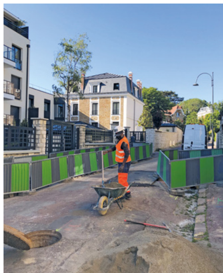
Réhabilitation du réseau d'assainissement rue Michel-Voisin (partie sud) par Vallée Sud – Grand Paris (VSGP).
