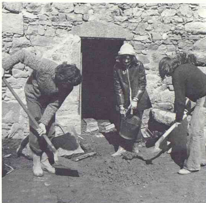
Au camp-chantier de Carsan, ciment, pelles et seaux... et par pour faire semblant !
