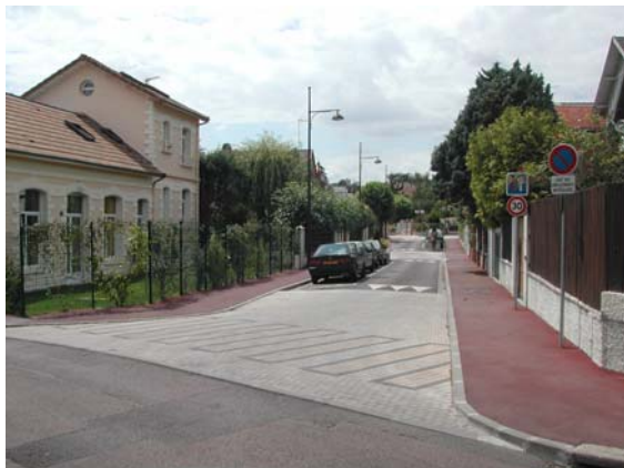
A l'occasion d'une opération de rénovation lourde de la voirie, la rue Jacqueline et la rue Marguerite sont réaménagées de façon à leur donner un caractère pacifié, propice à la limitation de la vitesse. L'entrée de zone, légèrement surélevée, est réalisée en pavés
